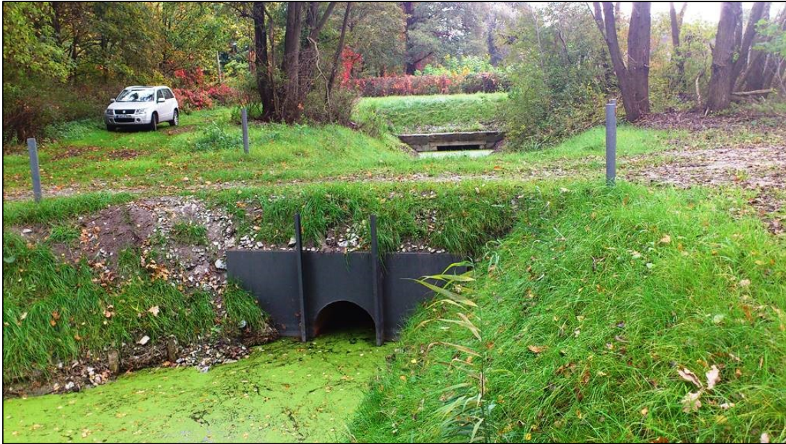
Abb. 16: Mögliche Ausführungsvariante für ein regulierbares Staubauwerk – Stahlrohr mit angeschweißtem Staurahmen (Foto: WBV „Dahme-Notte“)
