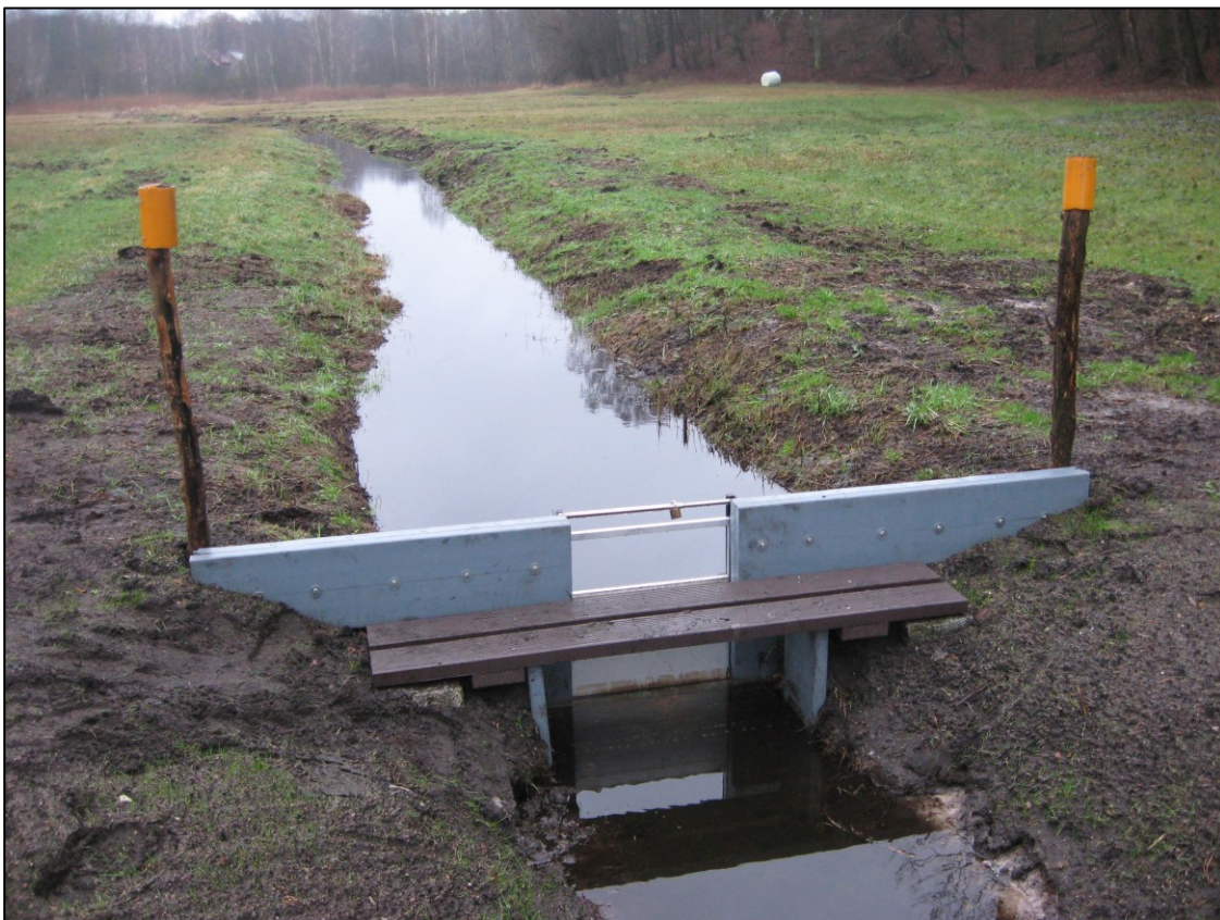
Abb. 17: Moorgrabenstauanlage „Typ Beeskow“ (Foto: WBV „Mittlere Spree“)
