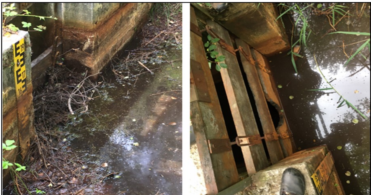
Abb 4: Defekte Wehre am Pegel P2 (linke Seite: fehlende Holzbretter im oberen Teil) sowie am Pegel P3 (rechte Seite: Loch im Brett sowie mehrere offene Elemente) (ECOSAX GmbH 2019)
