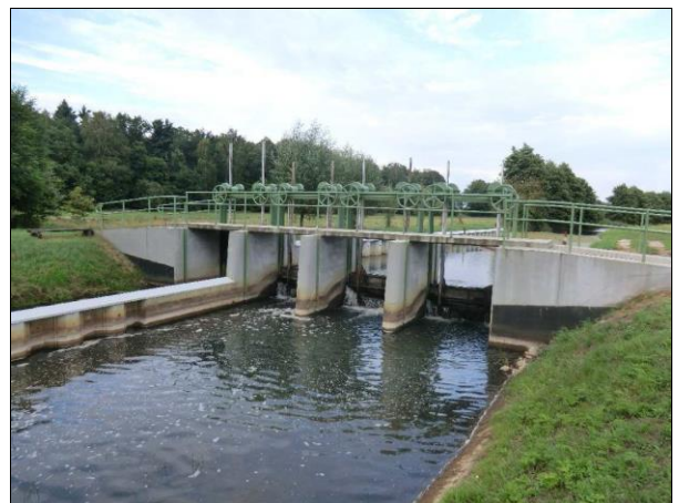
Abb. 14: Wehr Lenzersilge, 4-Felder Doppelschütz mit Fischaufstiegsanlage bei km 44,3 (Foto: Institut biota GmbH 2012, aus dem GEK – Bauwerkskataster)
