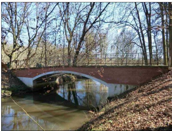
Abb. 13: Straßenbrücke (Kastenprofil) zwischen Babekuhl und Gadow bei km 42,9 (Foto: Institut biota GmbH 2012, aus dem GEK – Bauwerkskataster)
