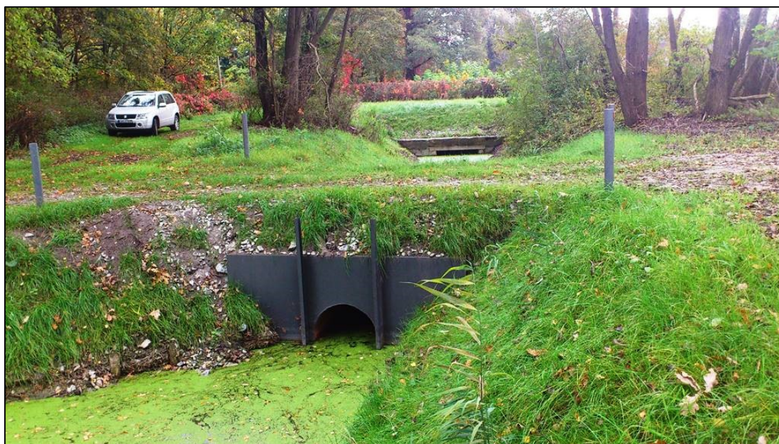
Abb. 17: Mögliche Ausführungsvariante für ein regulierbares Staubauwerk – Stahlrohr mit angeschweißtem Staurahmen und Überführungsmöglichkeit (Foto: H. Tesch)
