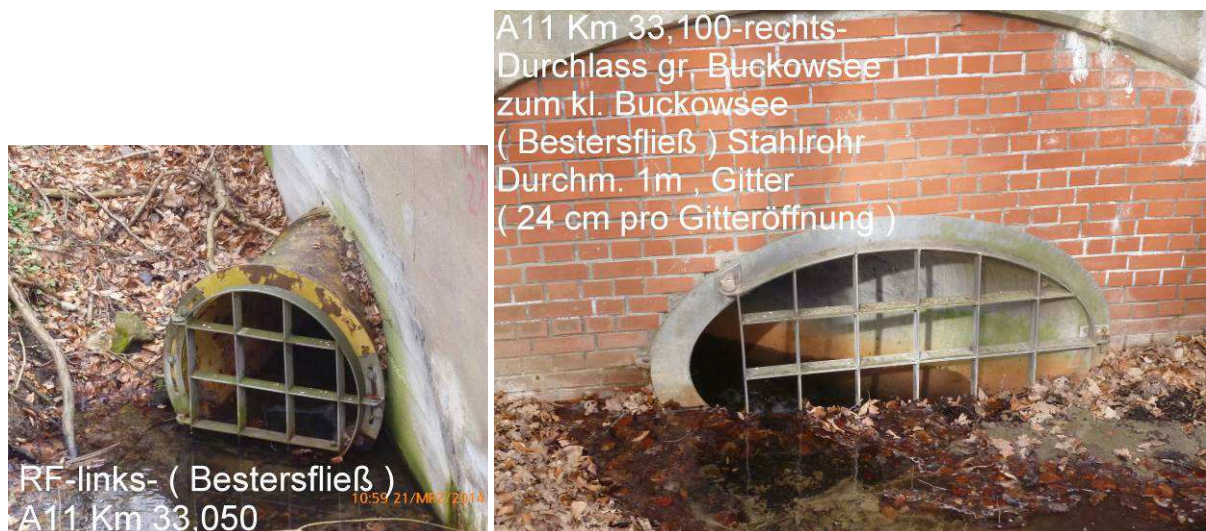
Abb. 12: Rohrdurchlass Bestersfließ am Großen Buckowsee. Fotos: Autobahnmeisterei Bernau
