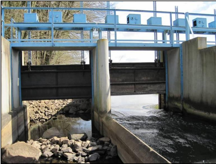
Abb. 20: Fischwanderhilfe (links im Bild) und offenes Wehrschütz (rechts im Bild) am Wehr Stavenow bei km 53,0 (Foto: I. Wiehle, 16.04.2015)
