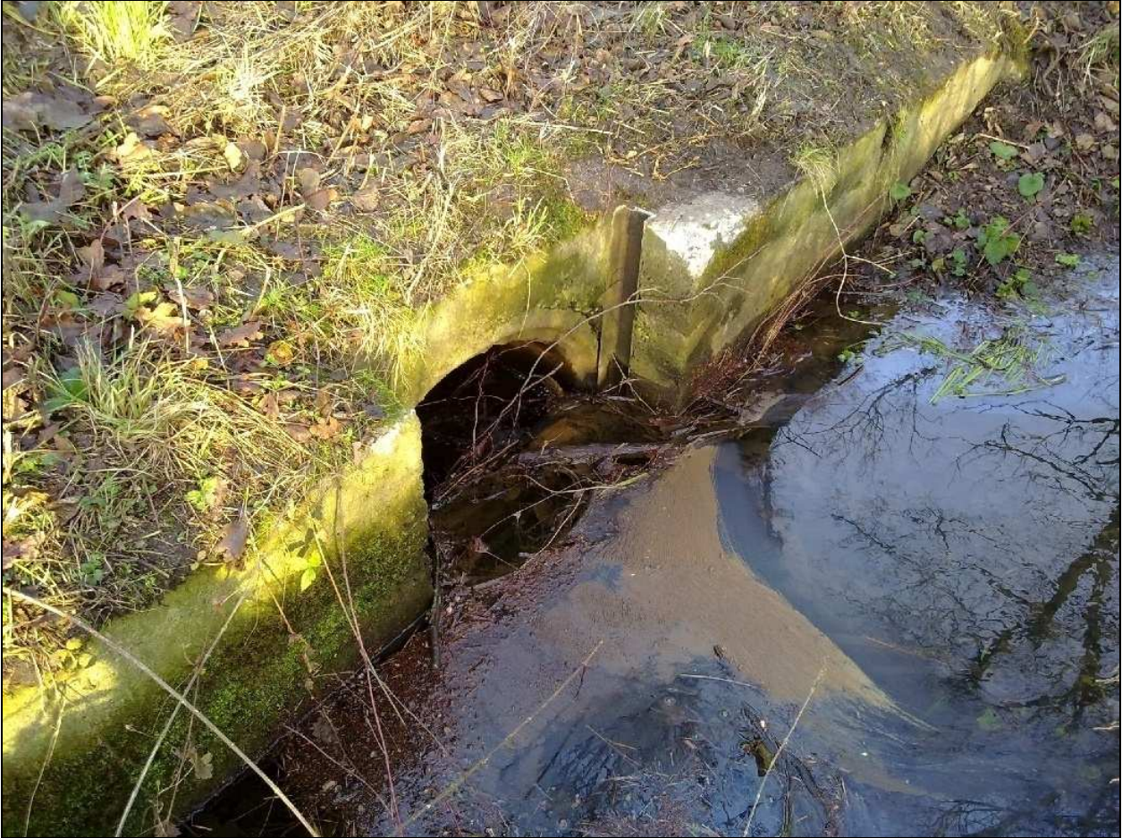
Abbildung 22: Nicht mehr intaktes Balkenwehr am Pankowgraben (Stand: 18.12.13), © Photo: Jendrik Terasa
