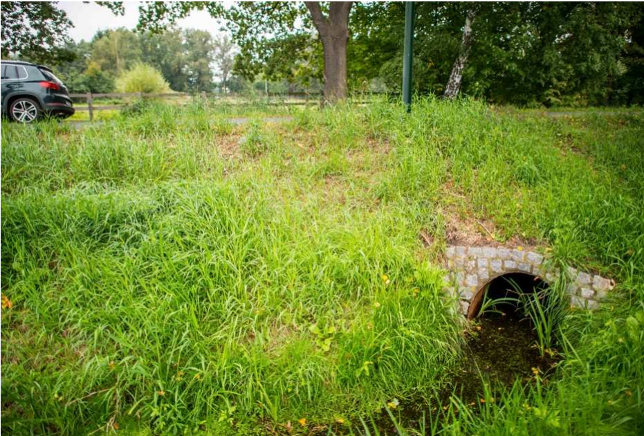
Rohrdurchlass Schlossgraben / L70 in Stülpe, nicht ottergerechtes Kreuzungsbauwerk (Foto: K. U. Hartleb 2013)
