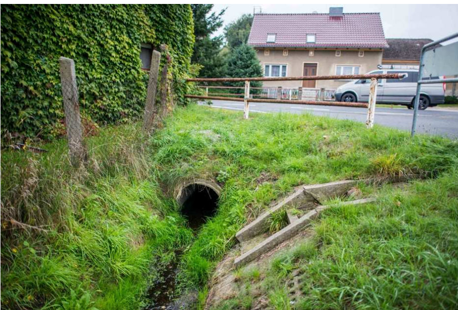
Rohrdurchlass Schlossgraben / L73 in Stülpe, nicht ottergerechtes Kreuzungsbauwerk (Foto: K. U. Hartleb 2013)
