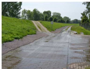
Bild 2: Sickerwasseraustritt am Deichfuß während des Hochwassers im Juni 2013
