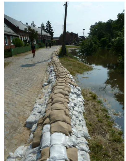
Bild 3: Müggendorf, Sandsackaufkaden im westlichen Abschnitt, 09.06.2013
