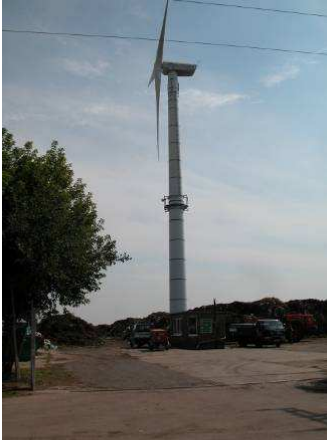
Abb. 3-51: Eine von zwei WKA direkt auf dem Gelände einer Kompostieranlage bei Hohendodeleben (Bördekreis, Sachsen-Anhalt)(30.07.2008, U. Mammen).
