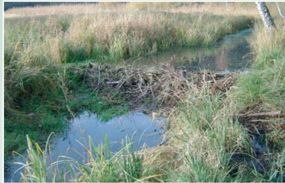
Vom Biber überbaute Sohlschwelle im Burower Hauptkanal (Foto: S. Weiß)
