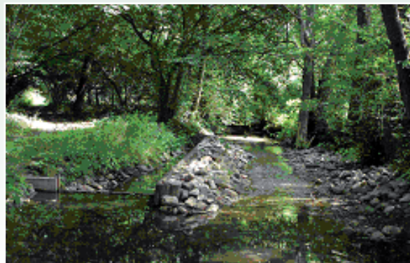
Stau (links) mit Umgehungsgerinne (rechts) am Auslauf des Roofensees (Foto: S. Weiß)
