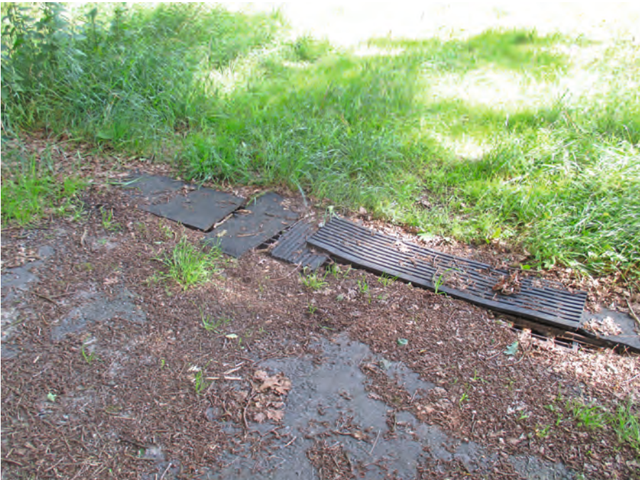
Abb. 6 Unbefugt ausgelegte Kunststoffmatten und aufliegendes, nicht beräumtes Laub an Grundstückszufahrten machen die Gitterroste einer Anlage im Landkreis Prignitz für Amphibien passierbar Foto: C. Kronmarck
