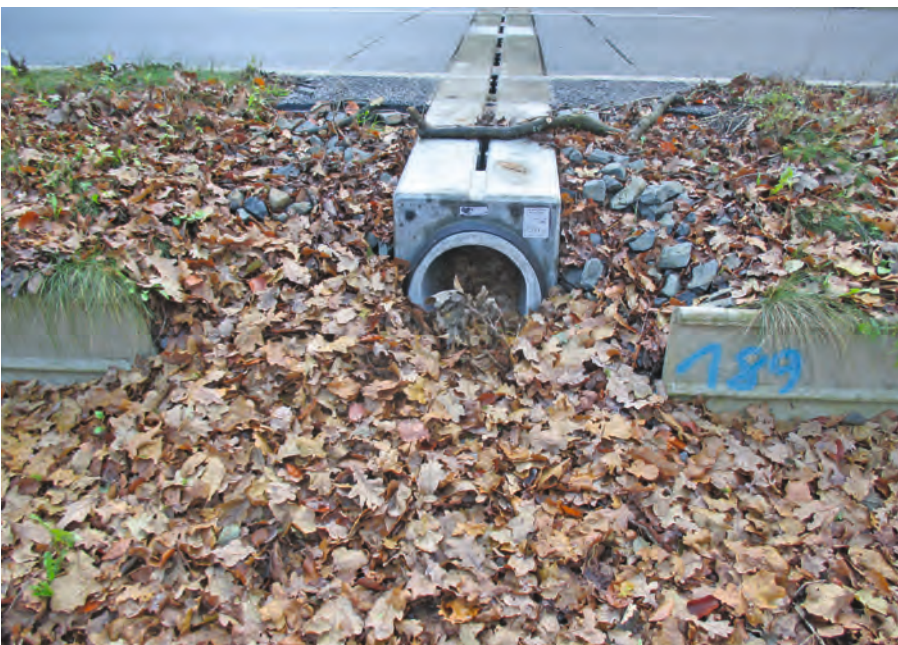
Abb. 7 Mangels Reparaturen hat eine Leiteinrichtung im Landkreis Havelland keinen Anschluss an den Durchlass mehr, dieser ist außerdem halb mit Laub verstopft. Wandernde Amphibien werden daher kaum noch am Überqueren der Straße gehindert Foto: S. Jansen
