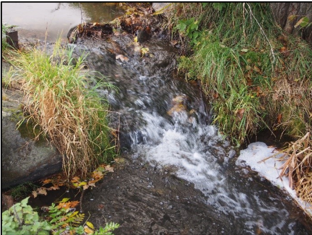
Abb. 45: Sohlabsturz an ehemaligem Wehrstandort
