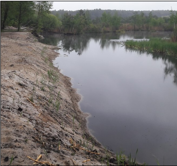
Abb. 25: Wasserspiegelabsenkung und Uferabschiebung im Kleinen Torfstich (ID_0285) (BRUNKOW 2020)
