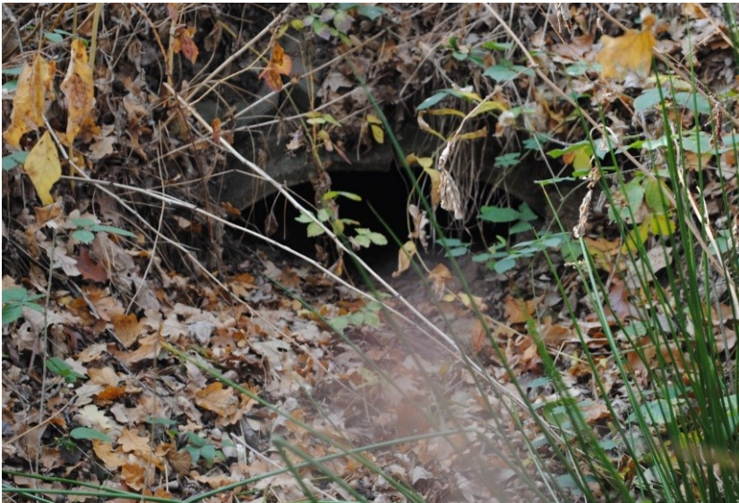
Abb. 16 Wanderhindernis für den Fischotter am Durchlass des Grabens Bi 79 unter der B 96 (U. List; D. Witt, 07.11.2018)
