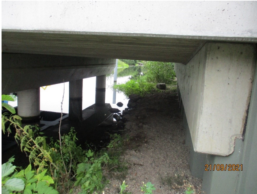
Abbildung 11: Berme am südlichen Ufer des Brückenbauwerks der L21 in Liebenwalde (Hoffmann, 21.09.2021)
