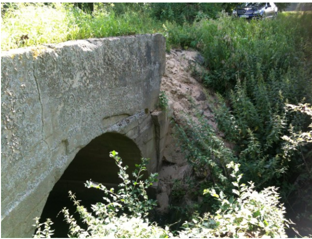
Foto 1: Schäden an Brücke über das Buderoser Mühlenfließ
