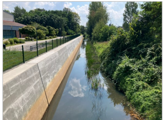
Abb. 13 – 4. Bauabschnitt, umgebaute Uferwände, Blick von Brücke Waldhufenstraße kanalabwärts in Richtung Süden (Gewässer-km 1+225), Foto: LfU Referat W 25, Juni 2024
