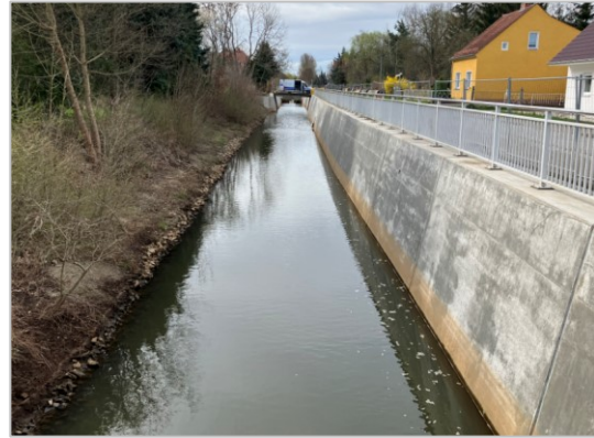
Abb. 7 – 2. Bauabschnitt, umgebaute Uferwand, Blick von Brücke Siedlerweg kanalabwärts in Richtung Süden (Gewässer-km 1+545), Foto: LfU Referat W 25, März 2023
