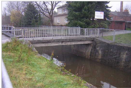
Abb. 18 – Brücke 5, Bestand, Blick von Friedrich-Ludwig-Jahn-Straße in Richtung Nordosten (Gewässer-km 1+370), Foto: BDC Dorsch Consult GmbH, November 2010
