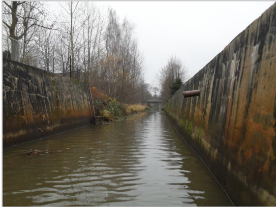
Abb. 10 – 3. Bauabschnitt, Bestand Uferwand, Blick von Sohle kanalabwärts in Richtung Süden (Gewässer-km 1+365), Foto: BDC Dorsch Consult GmbH, September 2013
