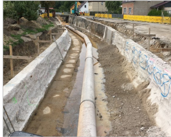
Abb. 3 – 1. Bauabschnitt, Bestand Uferwände nach Teilabbruch, Blick von Brücke Herzberger Straße kanalabwärts in Richtung Süden (Gewässer-km 1+650), Foto: IPROconsult GmbH, August 2021
