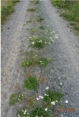
Foto 1: Risse auf Radweg
