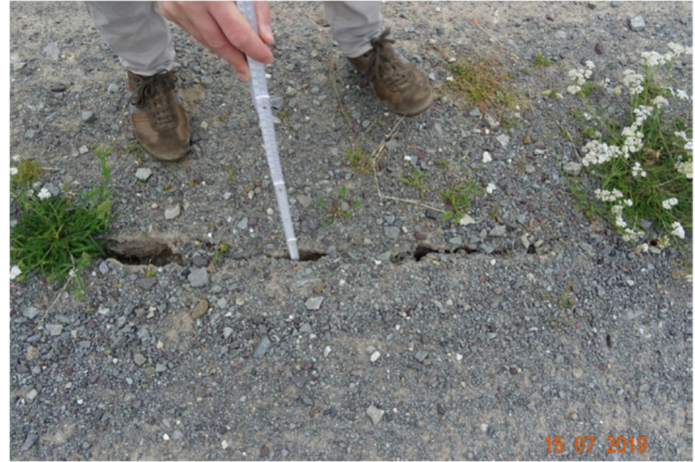
Foto 2: Risse 20 cm tief
