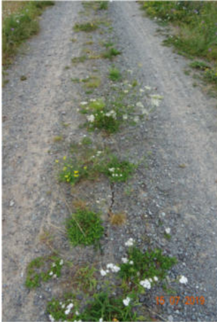
Foto 1: Risse auf Radweg
