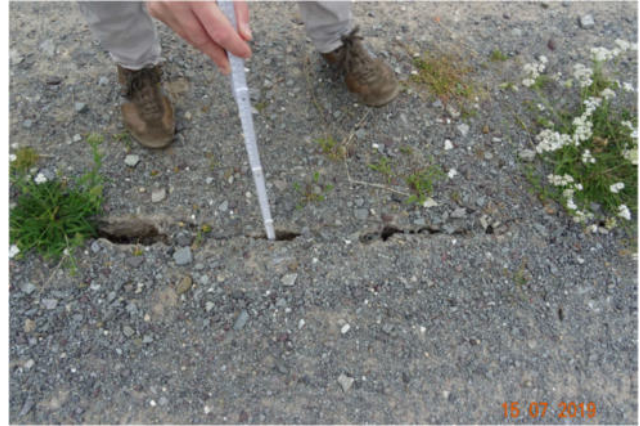
Foto 2: Risse 20 cm tief
