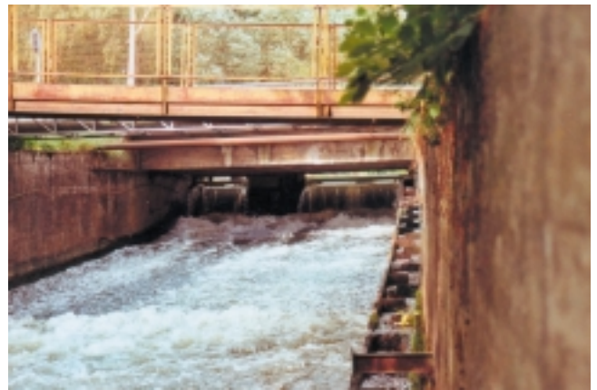
Foto 1: Wehr Hohenofen im Unterlauf der Dosse. Das undurchgängige Querbauwerk, das mit Betonwänden und Stahlträgern stark verbaute Ufer und der verursachte Rückstau stehen für eine „vollständig veränderte (7)“ Gewässerbettdynamik.
