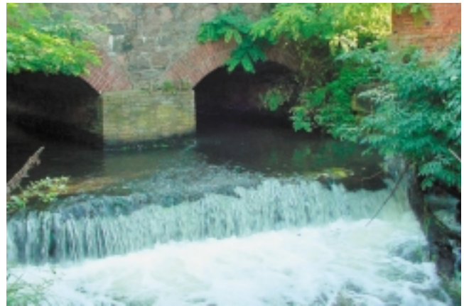
Foto 3: Dieser undurchgängige Absturz in der Alten Oder kann von den meisten aquatischen Lebewesen nicht überwunden werden, so dass eine Migration und damit eine Biotopvernetzung unterbunden ist. Darüber hinaus verursacht das Wehr einen Rückstau des Wassers.
