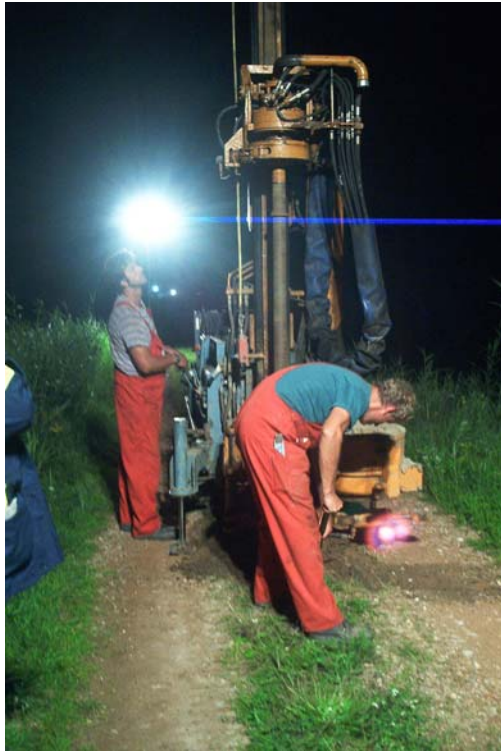
Havelpolder "Schafhorst" in der Nacht vom 20. zum 21.08.02: In den Deich werden Löcher für die Aufnahme der Sprengladungen gebohrt.
