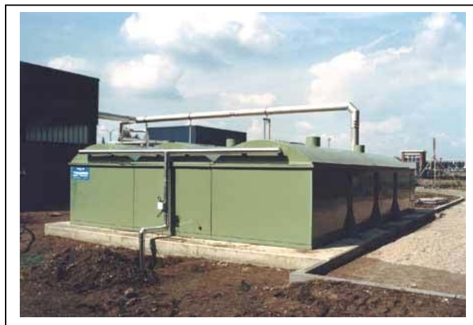
Abb. 2: Geschlossener Biofilter (Quelle: Tholander Ablufttechnik GmbH)
