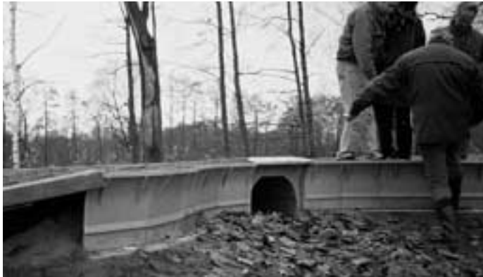
Abb. 6 Die Verbindung der Recycling-Kunststoffleitelemente an die Polymerbetonleitelemente ist sehr mangelhaft. Die entstandene Nische ist für die Amphibien nicht zu umgehen. Durch Lücken gelangen die Tiere auf die Fahrbahn. (Kolkwitz, Hänchener Straße) Foto: N. Schneeweiß
