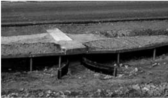
Abb. 5 Falscher Einbau der oberflächenbündigen Polymerbetontunnel. Die Klimaschlitze wurden mit einer Asphaltdecke überzogen - die Tunnel trocknen aus. (Pinnow, Umgehungsstraße) Foto: N. Schneeweiß
