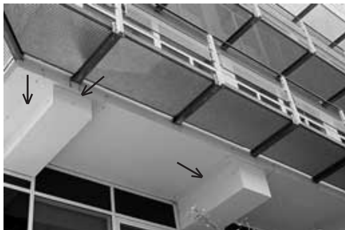
Abb. 4 Vernetzter Balkonträger nach genehmigter Entfernung der Mehlschwalben- nester Foto: J. Liehr
