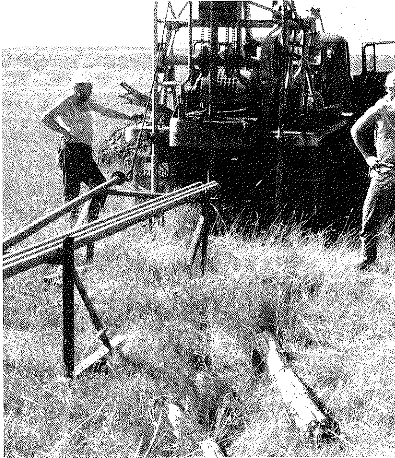
Bild 3 Nach dem „Klarspülen“ des Sprengbohrloches erfolgt der Ladungseinbau im vorliegenden Fall in zwei Etagen. Im Vordergrund sind zwei Sprengladungen abgelegt.
