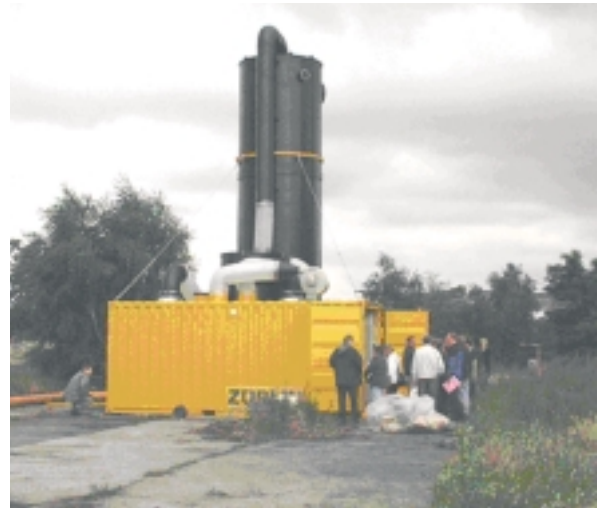
Abb. 4.2.1.3.2-1: Sanierungsanlage: Einstufige Stripanlage mit Luft-Aktivkohle-Filter in Kreisgasführung (Foto: A. WÜNSCH, 2002)
