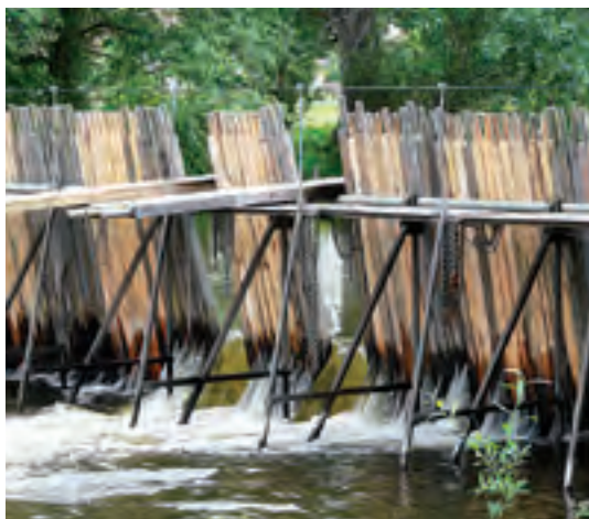
Abb. 6-1: Nadelwehr Alt Schadow – Beispiel für ein denkmalgeschütztes sanierungsbedürftiges Querbauwerk, das derzeit für die aquatische Fauna ein Wanderhindernis darstellt. Für die Herstellung der Durchgängigkeit – die Spree ist überregionales Vorranggewässer – wird ein Umgehungsgerinne vorgeschlagen. Ein ersatzloser Abriss kommt auch aufgrund bestehender wasserwirtschaftlicher Restriktionen nicht in Frage. (Foto: I. Hiekel, Juni 2009)
