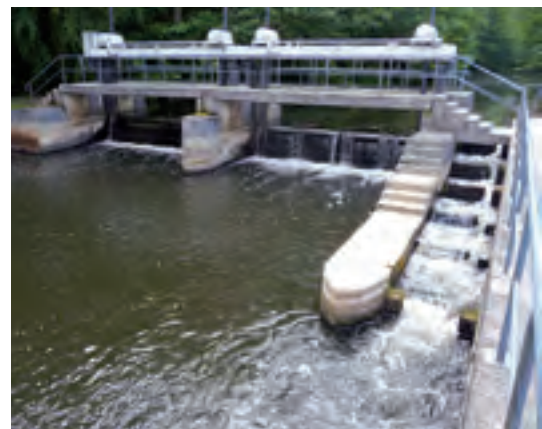
Abb. 5-7: Bestehende Fischaufstiegsanlagen sind teilweise nur eingeschränkt funktionstüchtig, so dass Nachbesserungen notwendig sind, wie z. B. am Unteren Puhlstromwehr. (Foto: W. Haas, Juni 2011)
