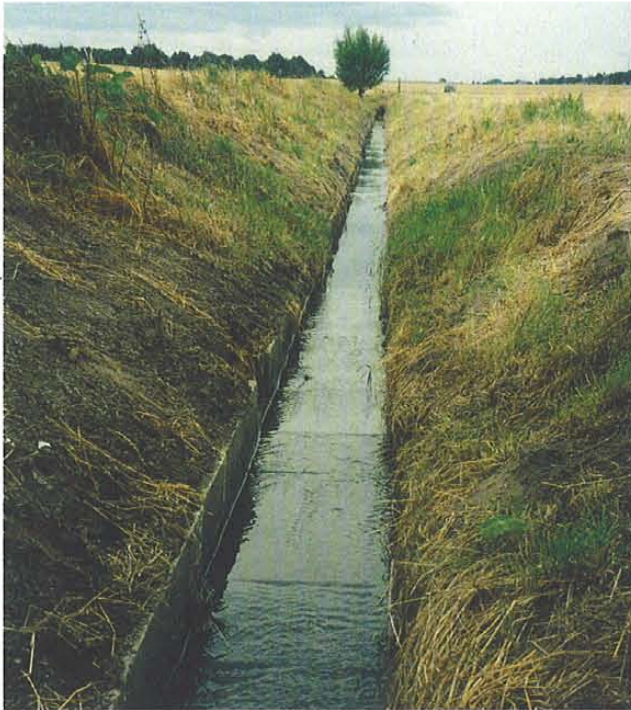
Abb. 28: Wernergraben vor Mündung in Neuenhagener Fließ, LK Märkisch-Oderland. Betonsohle, senkrechte Beton- wände, sehr starke Beeinträchtigung. Kann zur tödlichen Falle für kleine ufergebundene (Amphibien, Spitzmaus) Tierarten werden. (R. Scharf, 15.08.1995)
