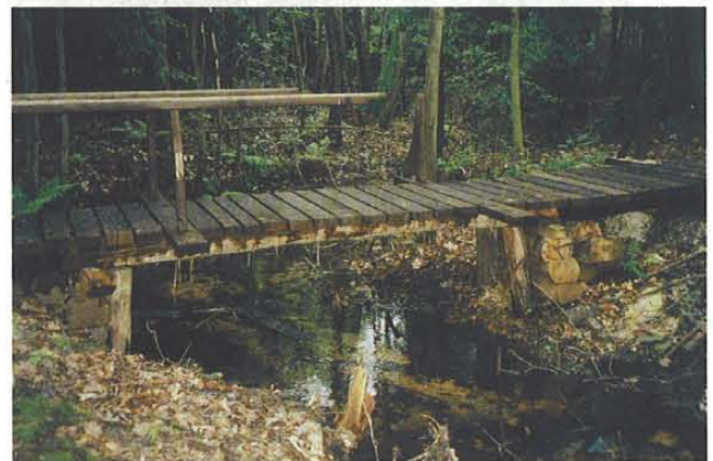
Abb. 27: Nieplitz, Durchlaß oberhalb Treuenbrietzen, LK Potsdam-Mittelmark, Brücke mit natürlicher Sohle unter Einbeziehung des Uferbereiches, keine Beeinträchtigung. (S. Ochmann, 27.05.1997)
