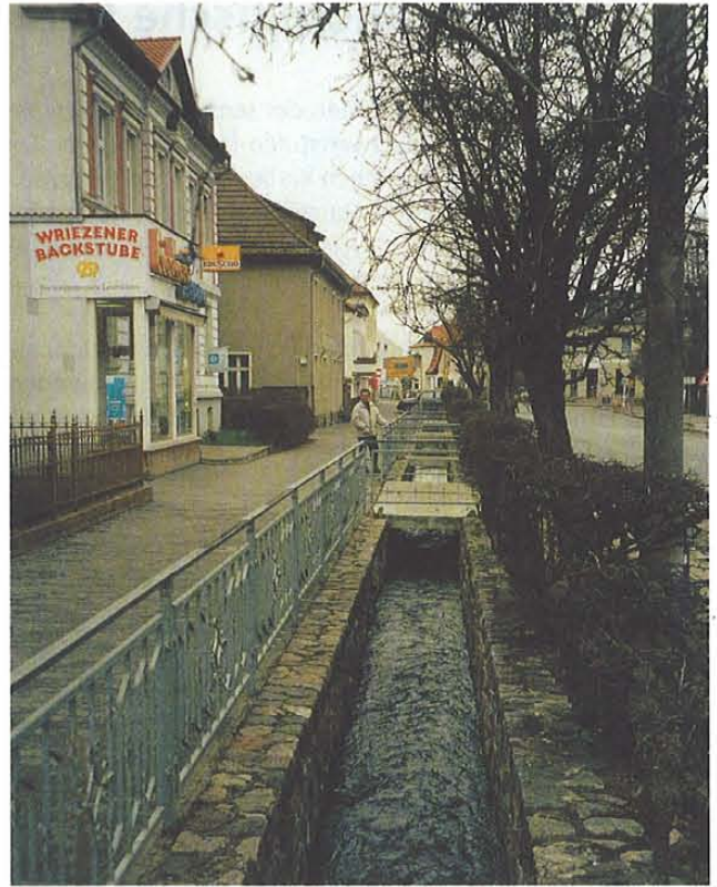
Abb. 48: Cöthener Fließ Falkenberg, LK Märkisch-Oderland; undurchlässige Sohle senkrechte Steinböschung. (S. Ochmann, 20.11.1996)
