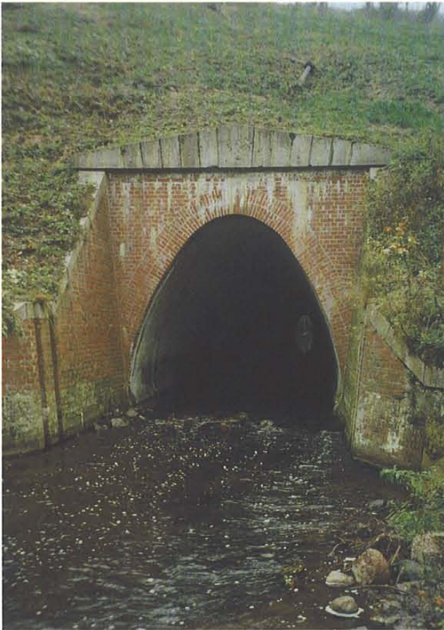
Abb. 24: Tunnel für das Ragöser Fließ unter dem Oder-Havel-Kanal, LK Barnim. Der lange Tunnel wirkt aus kleinklimatischen und optischen Gründen teilweise als Barriere; mittlere Beeinträchtigung, aufgrund fehlender Uferstreifen bleibt die Beeinträchtigung für ufergebundene Arten hoch. (S. Ochmann, 09.10.1996)
