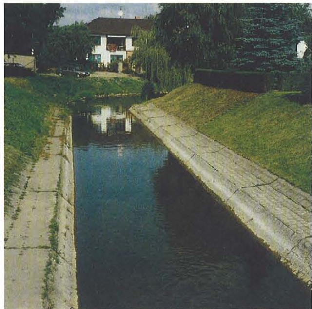
Abb. 31: Ausbaustrecke der Ucker in Prenzlau, LK Uckermark; Uferseite bis zur Sohle hin betoniert, starke Beein- trächtigung. (S. Ochmann, 03.09.1996)
