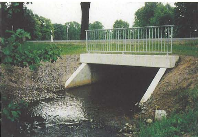
Abb. 22: Kastendurchlaß am Oegelfließ Stadtrand Beeskow, erbaut 1993, LK Oder-Spree. Durch Sohlbefestigung mit Beton und senkrechte Betonwände wird die Gewässersohle für bachaufwärtswandernde Tierarten, die im Substrat leben, unterbrochen. Uferstreifen fehlen; ufergebundene Tierarten wechseln i.d.R. über die Straße. (R. Scharf, 14.06.1994)
