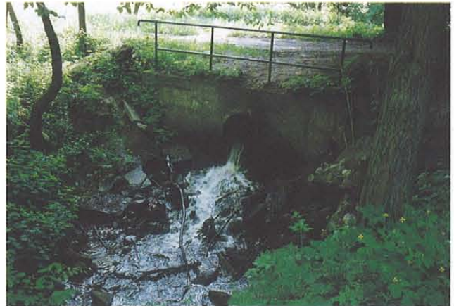
Abb. 21: Rohrdurchlaß am Rüdritzer Fließ nahe Langerönnner Mühle, LK Barnim. Neben der besiedlungsfeindlichen Betonsohle des Rohres (kein Sohlsubstrat im Rohr) verhindert das zu hoch liegende Rohrende (Absturz) jegliche Tierpassage. (R. Scharf, 01.06.1994)
