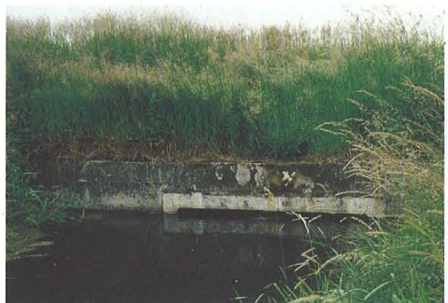
Abb. 23: Kastendurchlaß an der Oelse nordwestlich Schneeberg, LK Oder-Spree; Durchlaß, im begradigten Grabenabschnitt, für ufergebundene Tierarten nicht passierbar. (R. Scharf, 14.06.1994)
