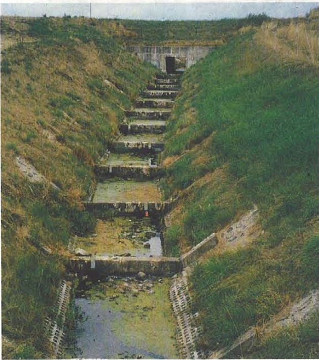
Abb. 34: Fischtreppe in der Kümernitz unterhalb Speicher Preddöhl, LK Prignitz. (S. Ochmann, 16.08.1995)
