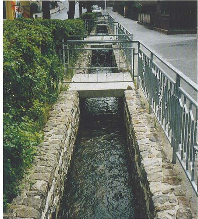
Abb. 29: Cöthener Fließ in Falkenberg, LK Märkisch-Oderland; neu kanalisierter Bachlauf. Sohle und senkrechte Wände aus ein- betonierten Steinen. Die extrem naturferne Gestaltung stellt eine sehr starke Beeinträchtigung dar. Kann zur tödlichen Falle für kleine ufergebundene (Amphibien, Spitzmaus) Tier- arten werden. (R. Scharf, 08.06.1994)
