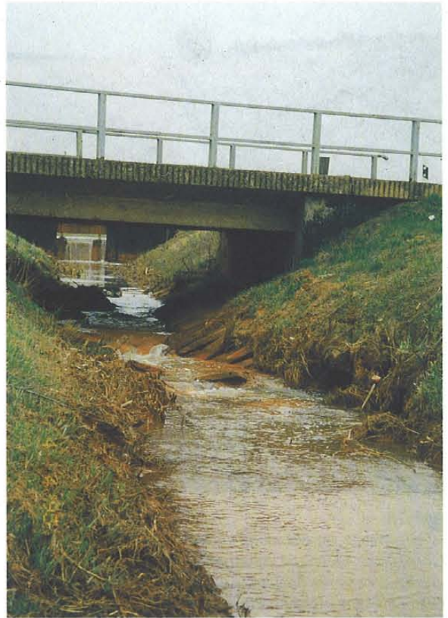
Abb. 25: Brücke am Ruhländer Schwarzwasser, LK Oberspreewald-Lausitz. Sohle und Ufer aus Betonplatten bestehend, die zum Teil unterspült sind; mittlere Beeinträchtigung. (S. Ochmann, April 1996)
