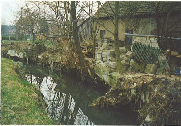
Abb. 35: Neue Pulsnitz in Großmehlen, LK Oberspreewald-Lausitz; Ufergestaltung durch Bauschutt, Beton und Gerümpel. Abstoßender Gesamteindruck; für die Durchgängigkeit nur als geringe Beeinträchtigung anzusehen, da nur an einem Ufer. (S. Ochmann, 09.03.1995)
