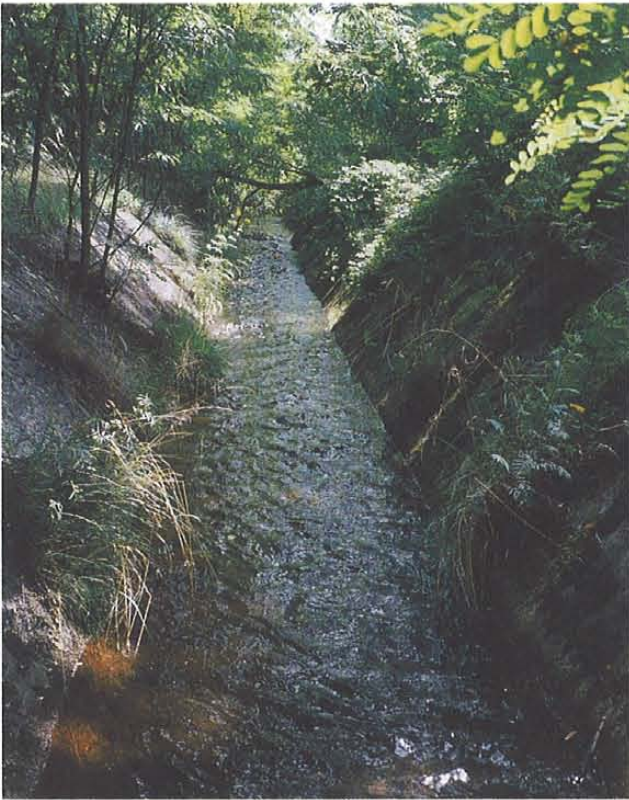
Abb. 47: Neues Bucholzer Fließ oberhalb Casel, LK Spree-Neiße. Durch Betonplatten an Sohle und Ufern zum Betongerinne degradiertes Fließgewässer (Grubenwassergefluder). (R. Scharf, 12.08.1993)
