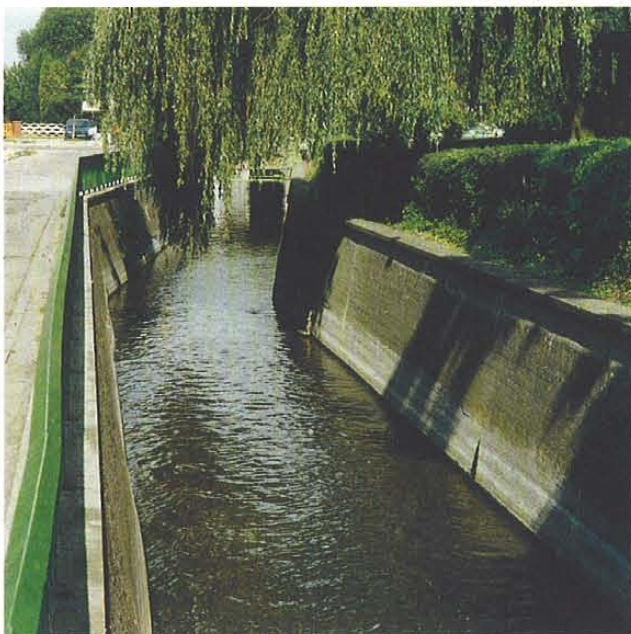
Abb. 30: Ausbaustrecke der Ucker in Prenzlau nahe Auslauf Uckersee, LK Uckermark; Sohle nicht betoniert, starke Beeinträchtigung. (S. Ochmann, 03.09.1996)
