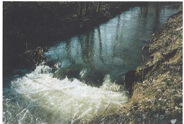
Abb. 14: Pfefferfließ zwischen Hennickendorf und Dobbrikow, LK Teltow-Fläming, Stahlspundwand, Sohlabsturz, starke Beeinträchtigung. (R. Scharf, 11.03.1994)
