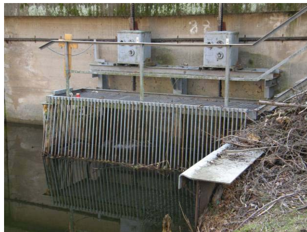
Abb. 162: Schützenwehr Templin (Unterwasser)
